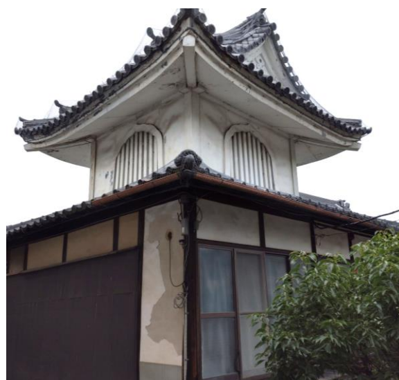
修復前の太鼓楼
